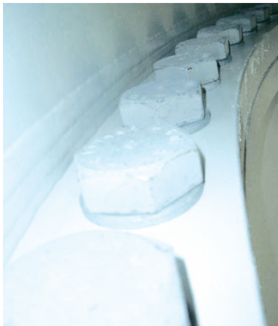
Ringflanschverbindung von Turmsegmenten einer Windenergieanlage
